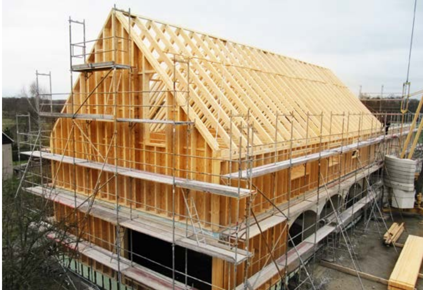
Vorort zusammengefügte Holzrahmenbauweise in der Bauphase; Die Außenseite wird anschließend verkleidet und die Dämmung in den Zwischenraum eingebracht.
