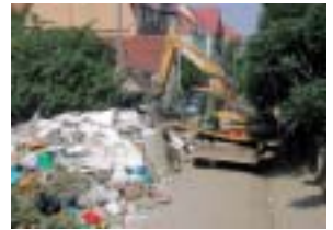
Tras la inundación: acumulaciones de escombros, por ejemplo en la calle Seidelbast de Dresde-Laubegast
