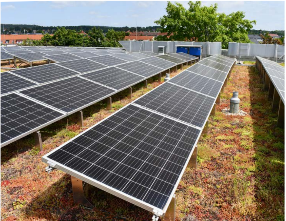
Solargründach - Kombination von PV-Anlage und extensiver Dachbegrünung schafft Synergien
