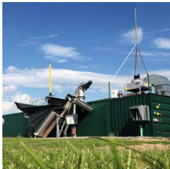
Abb. 75: Kleine Biogasanlage (Containeranlage) [agriKomp GmbH 2012]
