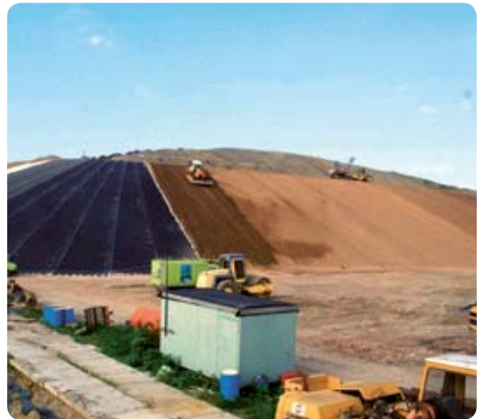
Die Deponie Gröbern (ZAOE) erhält eine Oberflächenabdichtung, um das Eindringen von Niederschlag in den Deponiekörper zu verhindern.
