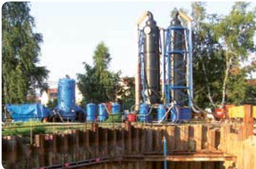
Bodenluftsanierung – bei einem ehemaligen Tanklager wird die mit leichtflüchtigen Schadstoffen angereicherte Bodenluft gereinigt.
