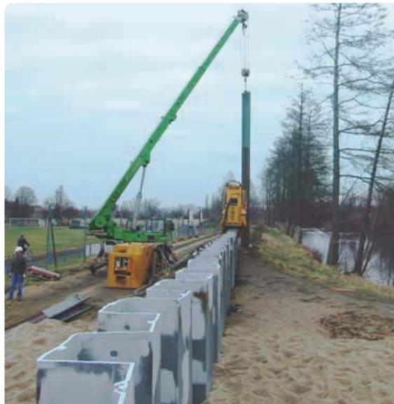
Abb. 36: Hochwasserschutzmaßnahmen in Ostritz
