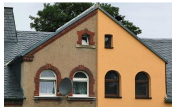
Problematische Fassadengestaltung nach der halbseitigen energetischen Sanierung eines Doppelhauses (kein Denkmalschutz) in Neustadt/V.
