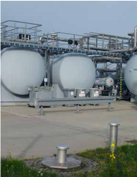
Oberirdisches Tanklager für Kraftstoffe
