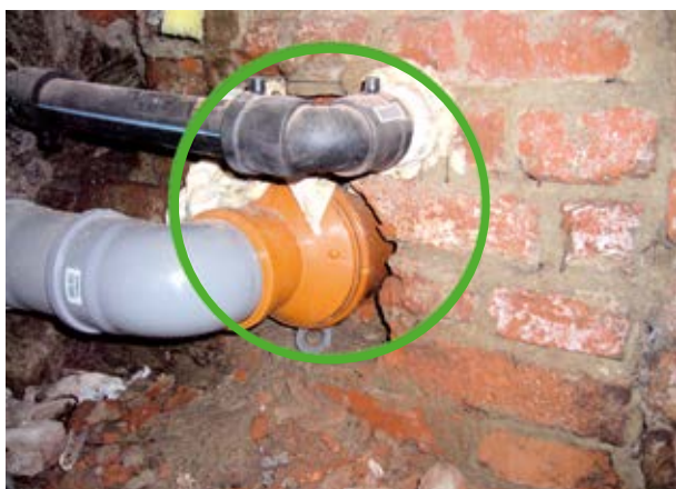
Radoneintrittspfade an unzureichend abgedichteten Leitungsdurchführungen
