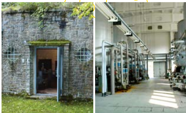
Anlagen der Wassergewinnung und -aufbereitung
