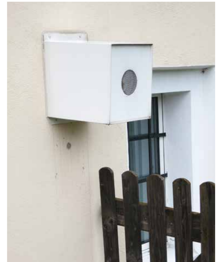
Rohrführung im Rahmen einer Unterbodenabsaugung über einen stillgelegten Abgasfang (Radonsanierung in einem Privathaus)
