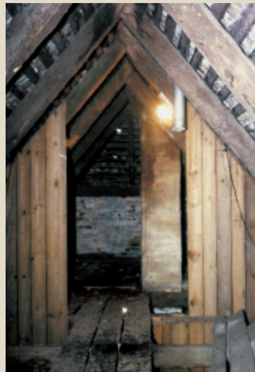
Dachboden mit Kotspuren auf den Dielen- brettern Foto: M. Dietz
