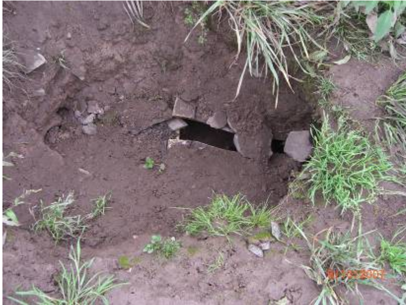
Abbildung 16: Defekte Drainage mit Ausspültrichter und Erosionsschäden
