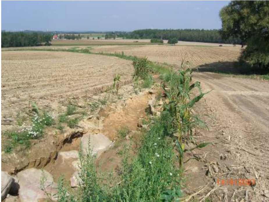
Abbildung 26: Nach Starkregen im Frühjahr 2007 aufgetretene Grabenerosion
