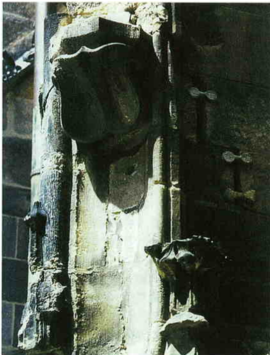
■ Abb. 6.4.2: Bauschäden am Zwickauer Dom
