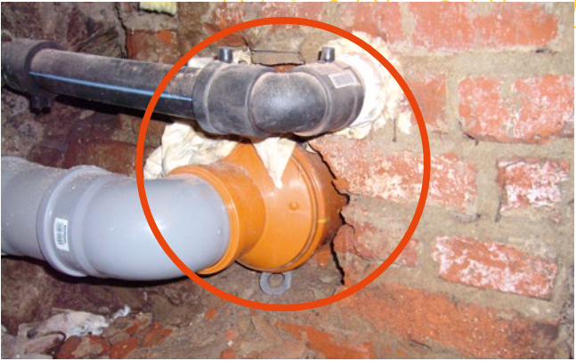
Radoneintrittspfade an unzureichend abgedichteten Leitungsdurchführungen Quelle: Staatliche Betriebsgesellschaft für Umwelt und Landwirtschaft
