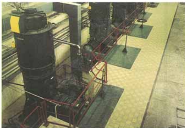
Abb. 2.20: Regen- und Schmutzwasserpumpwerk, Kläranlage Dresden-Koditz
