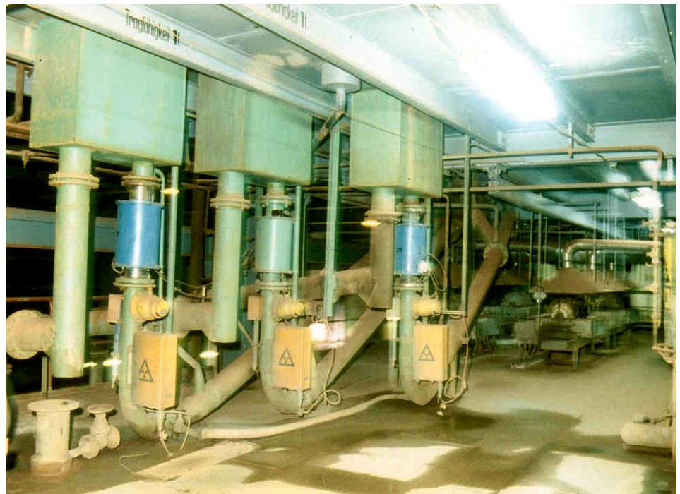
Abb. 162: Messeinrichtungen am Einlauf der Grundflotation (Zinngehalt, Trübedichte, Trübmengenge) Foto: M. BECKER
