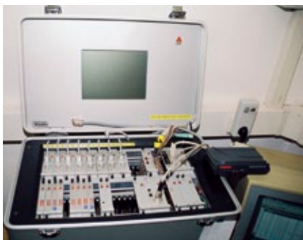
Abb. 23: Seismische Überwachungsanlage 3, Teilanlage Oberschlema
