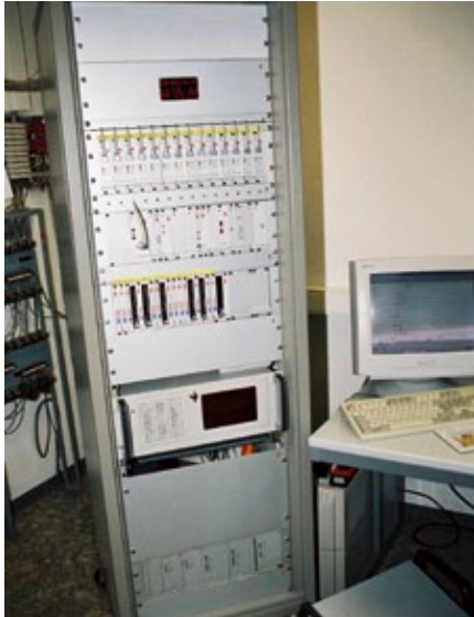
Abb. 22: Seismische Überwachungsanlage 3, Hauptanlage Schacht 371
