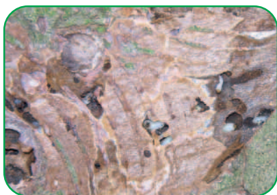
Abb. 53: Befall im Larvenstadium gestattet verschiedene Sanierungsmöglichkeiten
