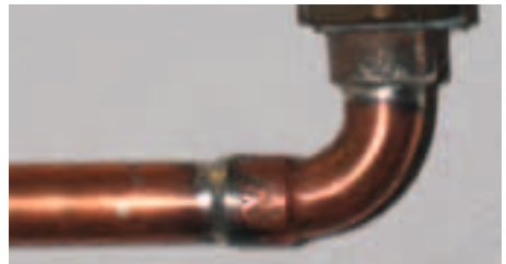
Heizungsrohr aus Kupfer
