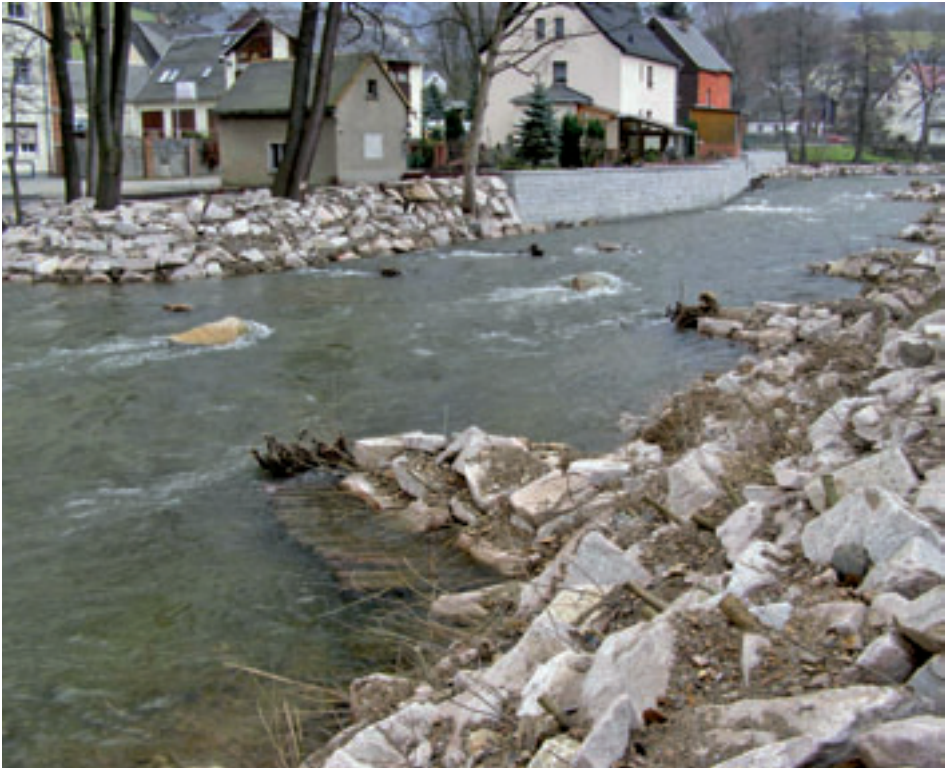
Abb. 13: Lebendbühnen in Kombination mit begrünter Steinschüttung gewährleisten unmittelbar nach der Baufertigstellung (November 2007) einen intensiven Uferschutz und verbessern gleichzeitig die Gewässerstruktur. Foto: A. Stowasser
