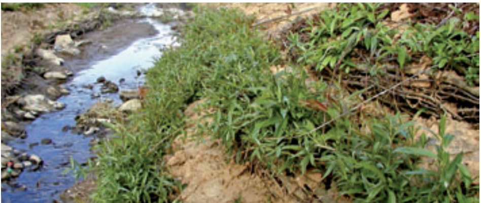
Abb. 8: Austrieb einer Lebendfaschine auf Buschlage vier Wochen nach Baufertigstellung (Ende April 2001) Foto: A. Stowasser
