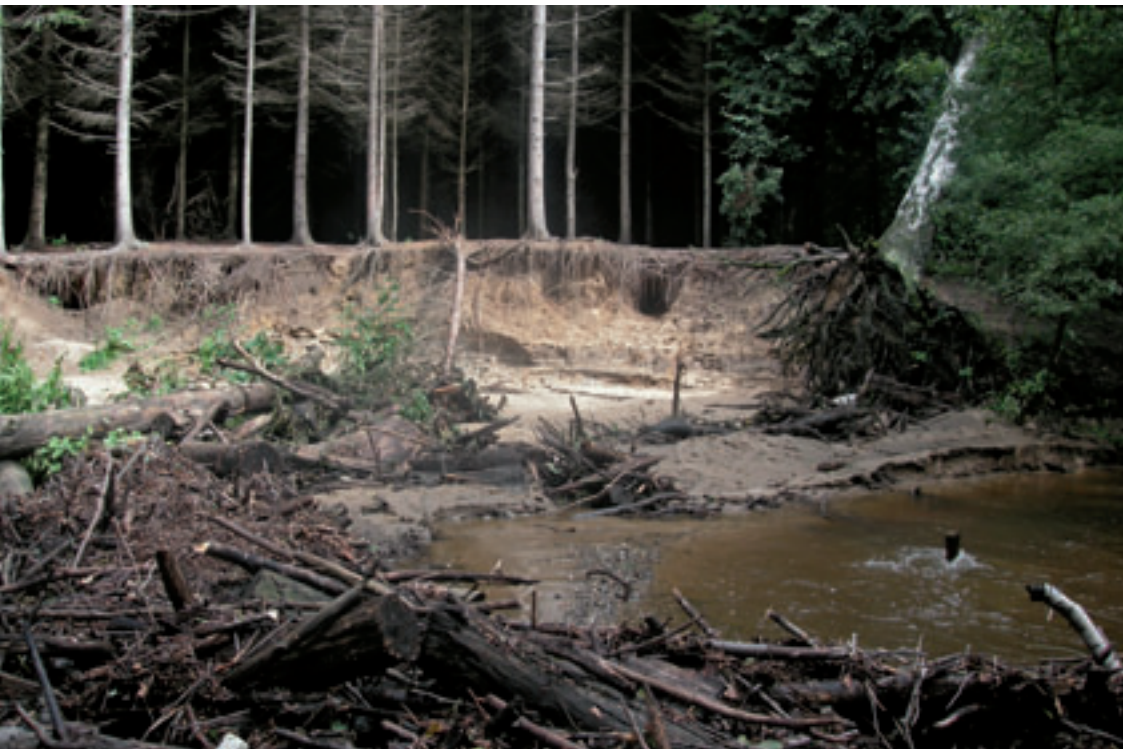
Abb. 2: Böschungsabriss am standortwidrigen Fichtenbestand infolge eines Hochwassers an der Prießnitz Foto: Archiv SBS
