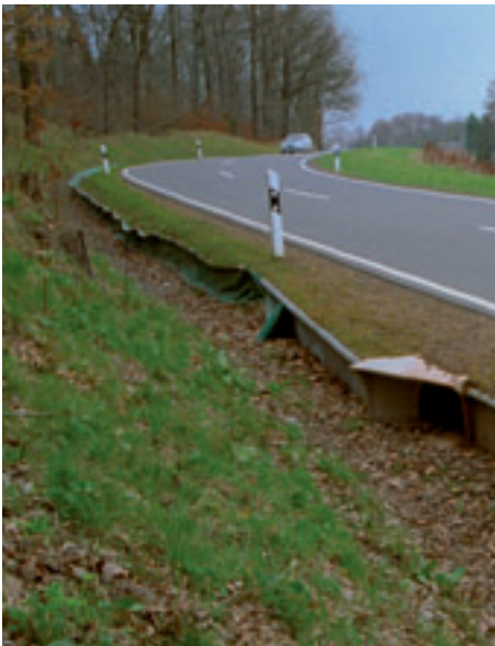
Abb. 4: Die Lücken in der Leiteinrichtung der Amphibienschutzanlage an der K 72 in Schellenberg müssen durch provisorischen Krötenzaun geschlossen werden. Foto: V. Kuschka
