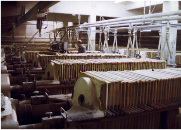
Abb. 73: Hochgestellte Filterpressen kamen im Werk I ab 1974 zum Einsatz. Die Entleerung der Pressen erfolgt nach unten, die Filterkuchen wurden über Bänder abgefördert.
