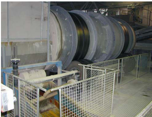
Abb. 76: Schlammtrammel zur Dispergierung des Rohkaolins, Schlammerei Gröppendorf
