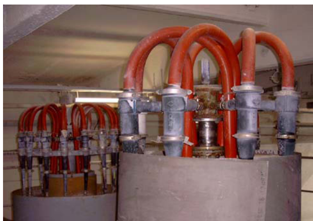
Abb. 77: Hydrozyklonbatterie in der Produktionsabteilung I der Kemmlitzer Kaolinwerke
