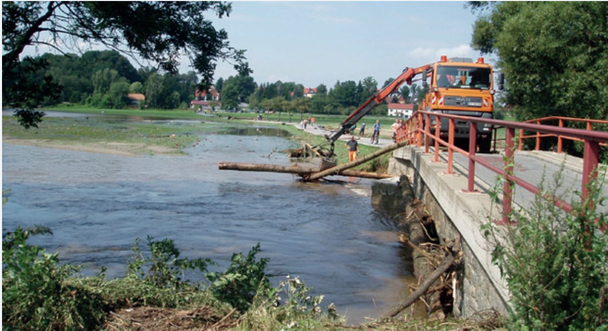
Abbildung 6-15: Beräumung der verklausten Straßenbrücke in Grubschütz (Spree) (Foto: LTV)
