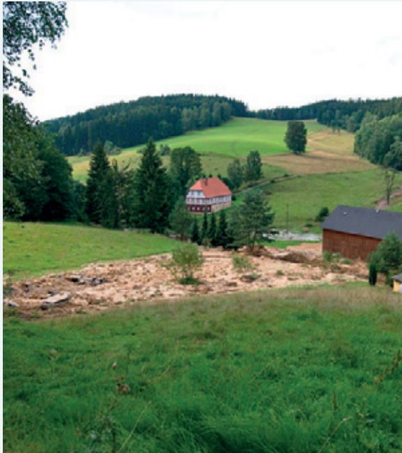
Abbildung 6-24: Wild abfließendes Wasser nach der Zerstörung eines Straßendamms an der Straße nach Hinterhermsdorf (Landkreis Sächsische Schweiz-Osterzgebirge) im August 2010 (Foto: R. Schneider)
