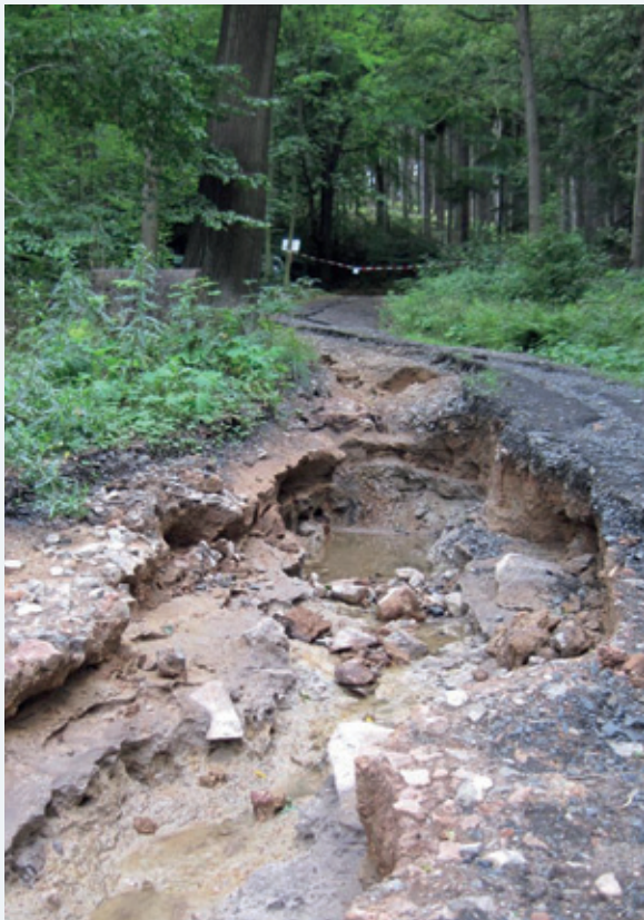
Abbildung 6-31: Schäden am Bärchelweg (Revier Jonsdorf) durch wild abfließendes Wasser während der Starkniederschläge des 06.08. und 07.08.2010 (Foto: Stadtverwaltung Zittau)
