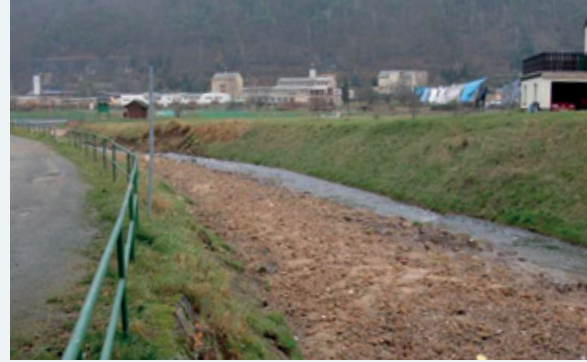
Abbildung 9-76: Geröllablagerungen im Mündungsbereich des Krippenbaches in die Elbe nach dem Hochwasser 2010 (Foto: Stadtverwaltung Bad Schandau)
