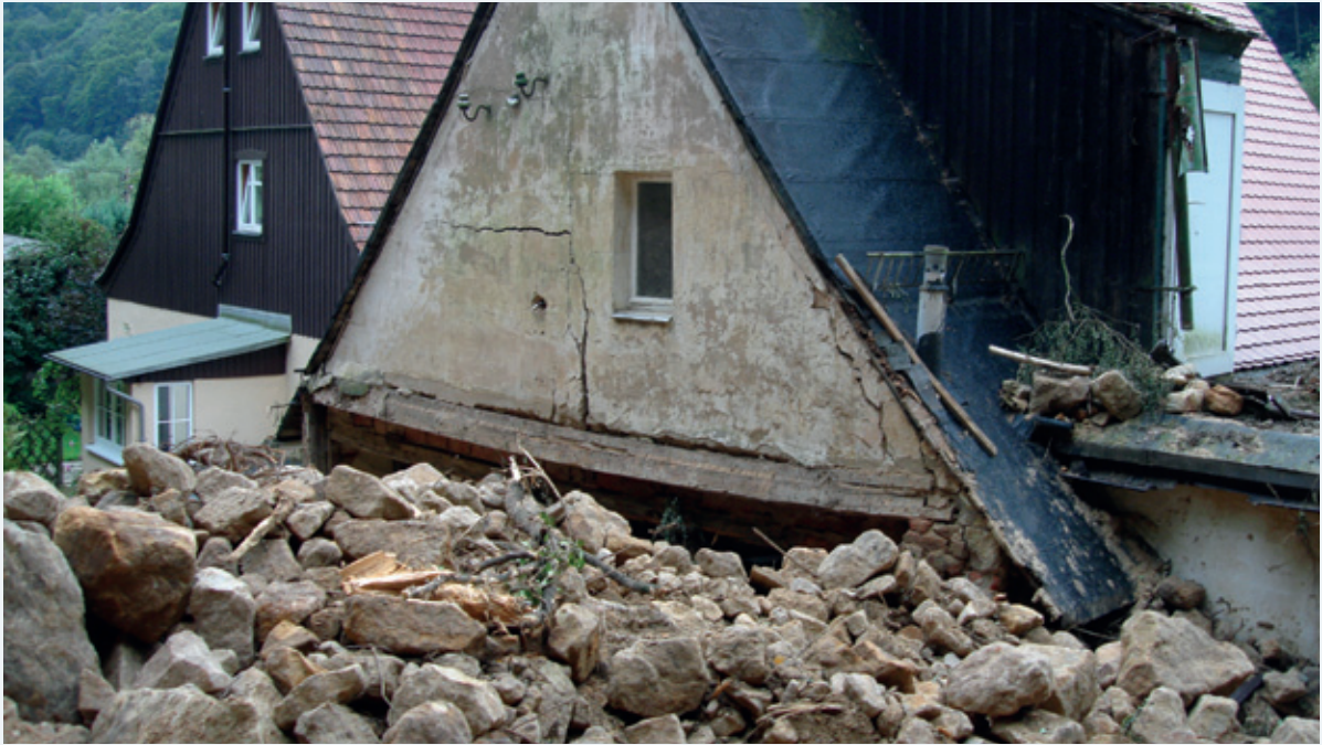
Abbildung 9–40: die Rückseite des stark beschädigten Wohngebäudes Pirnaer Straße 199 (Foto: Bauamt Lohmen, 2010)
