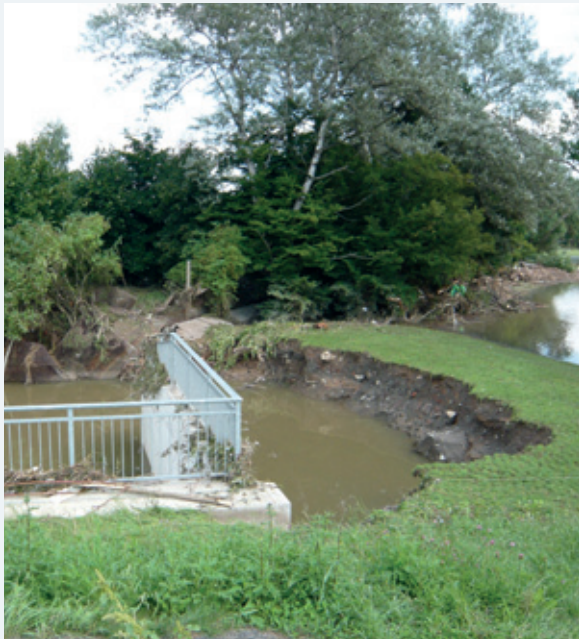
Abbildung 9-18: Ostritz, Kolk am Sielbauwerk (Foto: LTV)
