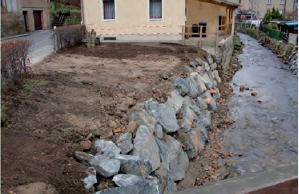
Abbildung 9-79: Maßnahmen Sofortsicherung 2010 (Foto: Stadtverwaltung Bad Schandau)
