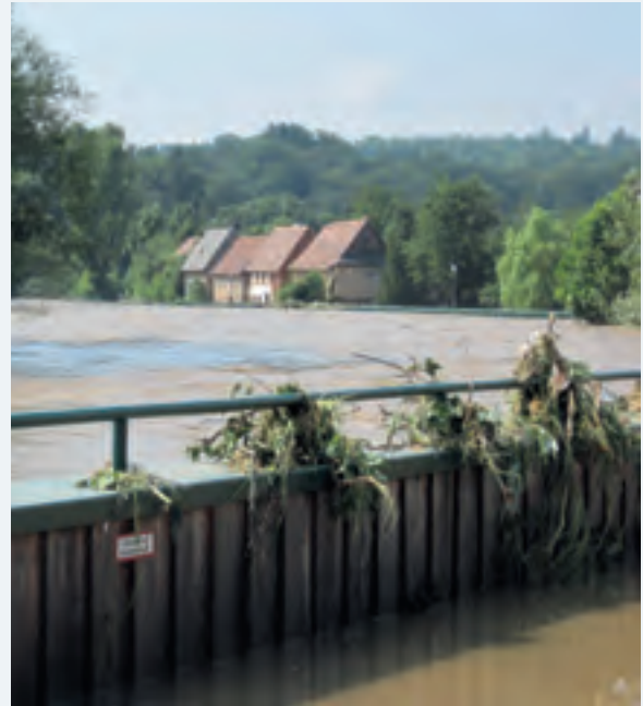
Abbildung 9-11: Überströmte Spundwand an der Klosterstraße (Foto: LTV)
