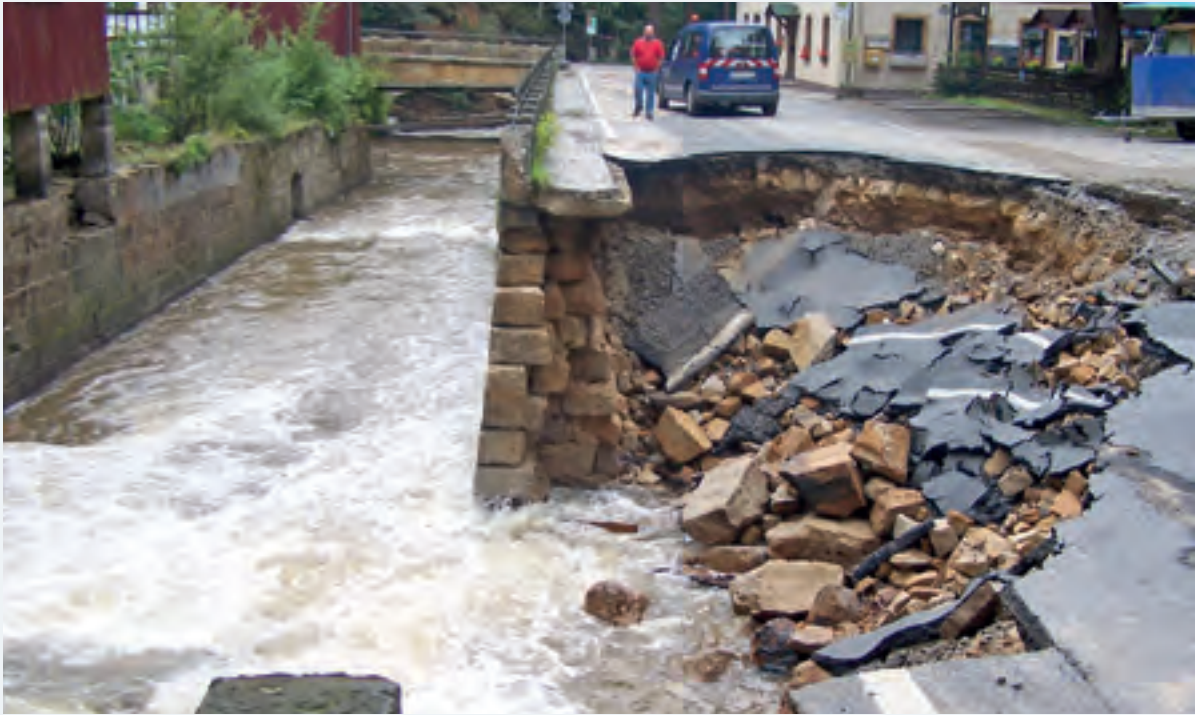
Abbildung 9-35: Straßenschäden oberhalb der Felsenmühle nach der Hochwasserwelle vom 07./08.08.2010 (Foto: LTV)
