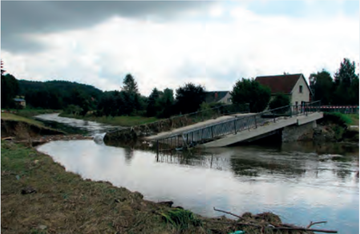
Abbildung 9-48: Zerstörte Brücke (Foto: Hr. Baldauf)
