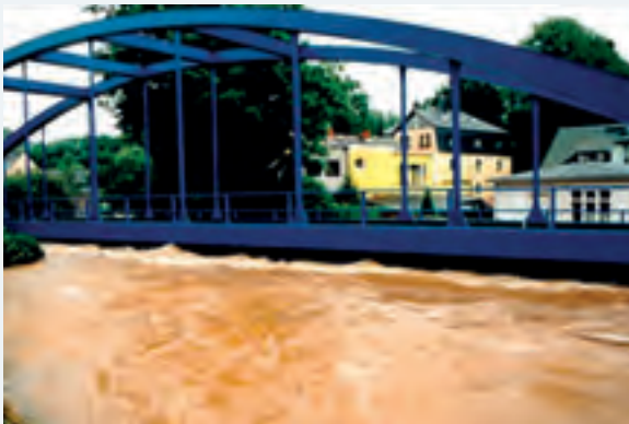
Abbildung 9-57: Einstau und Überströmen der Eisenbahnbrücke „Blaues Wunder“ in Chemnitz-Harthau am 07.08.2010 innerhalb weniger Stunden (Foto: LTV)
