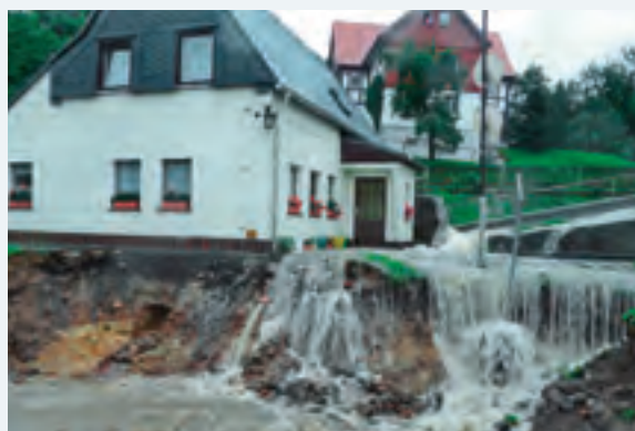
Abbildung 9-69: Zerstörte Ufermauer am unteren Mühlgraben in Bertsdorf (Foto: Bertsdorfer Heimatverein e.V.)
