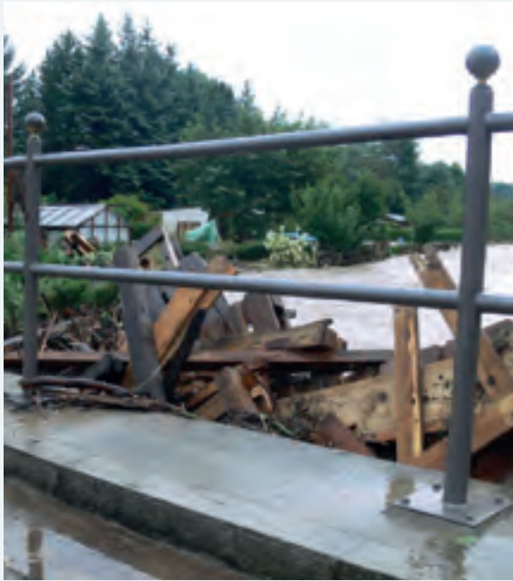
Abbildung 9-84: Verklauung an einer Brücke beim Hotel „Alten Weber“ in Weigsdorf-Köblitz (Foto: Gemeinde Cunewalde)
