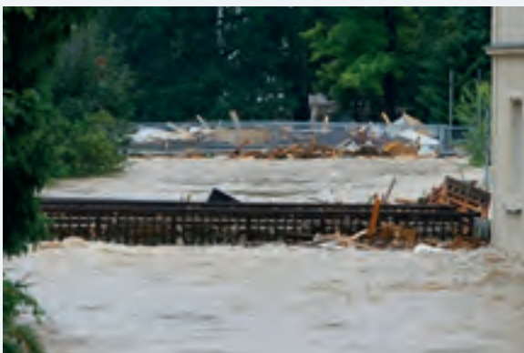
Abbildung 9-59: Verklausung Brücke Am Harthauer Bahnhof und Fußgängerbrücke Stöckelstr. (Foto: LTV)
