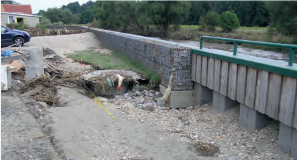
Abbildung 9-17: Klosterstraße mit sichtbaren Ausspülungen und Schwemmgutablagerungen (Foto: LTV)
