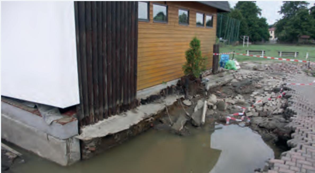
Abbildung 6-13: Tiefenerosion an einem Fußweg in Lodenau und abgesacktes Fundament eines unterspülten Gebäudes (Foto: Landratsamt Görlitz)
