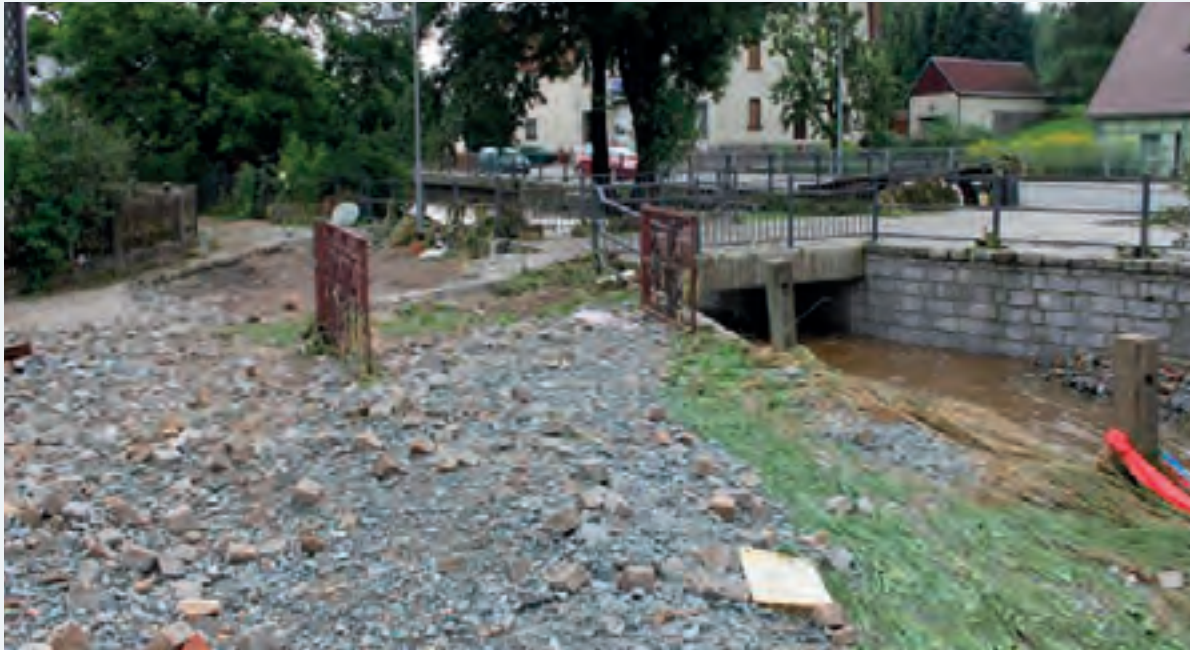
Abbildung 6-17: Erosion und Übersarung am Cunewalder Wasser (Foto: Gemeinde Cunewalde)
