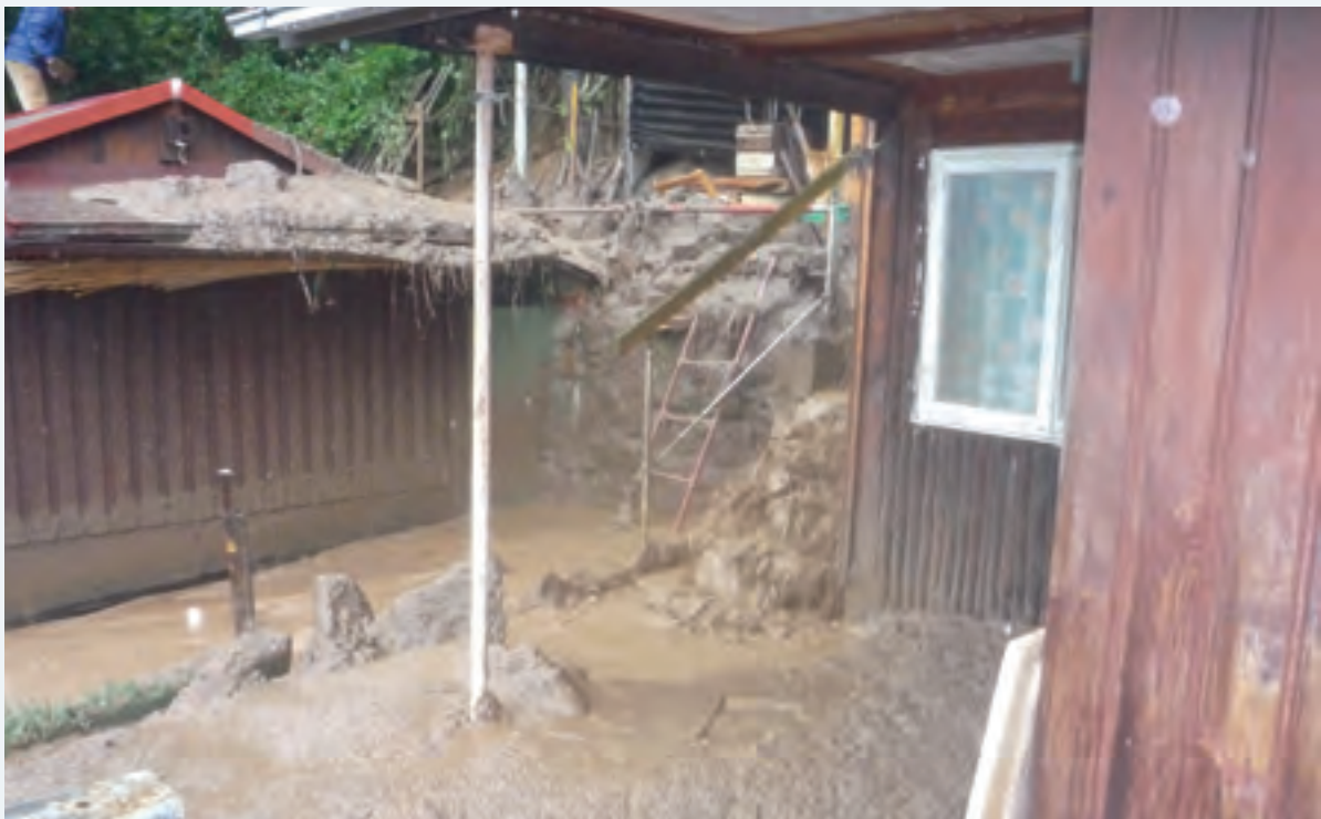
Abbildung 6-36: Teil des Schadenbereiches der großen Hangrutschung unterhalb der Festung Königstein (Foto: Feuerwehr der Stadt Königstein)
