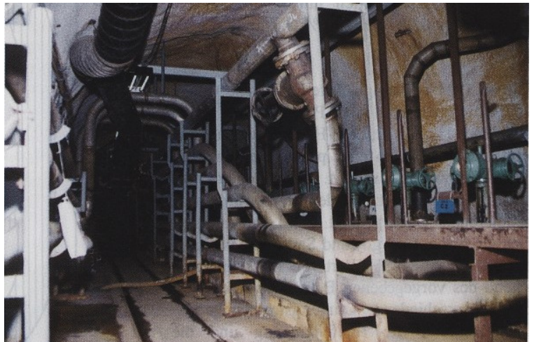
Abb. 168: Kollektorkammer, +94 m-Sohle, zur Verteilung der Aufgabe- und Sammlung der Rücklauflösung. Foto: J. KUGLER, 1996
