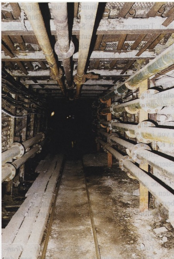
Abb. 170: Strecke für die Säure-Aufgabelitung, die von der Pumpstation zu einem der Laugungsblöcke führt. Rohrstrecke 4, +94 m-Sohle. Foto: H. Lausch, 1996
