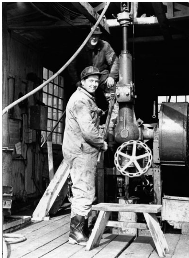
Abb. 9.2-19: Bohranlage vom Typ Craelius (verm. SIF 500, Gerät-Nr. 186). Mit diesem Gerät wurden 1958-1962 die Bohrungen Freital 6 bis 15, mit Maximaltiefe von 730 m, geteuft; Foto: REICHEL
