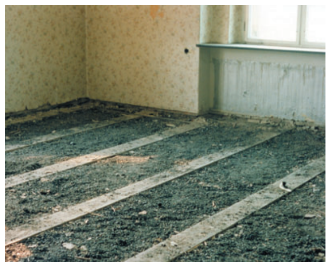
Abb. 14.8-6: Steinkohlenschlacken (häufig radioaktiv kontaminiert) zur Isolation der Zwischendecken von Wohn- und Bürogebäuden; Foto: SCHAUER (1993)
