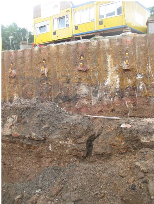
Abb. 8-2: Beim Bau des Tunnels der B 93 in Zwickau aufgeschlossene Stadtgrabenmauer, die durch bergbaubedingte Bewegungen auf der herzynisch streichenden „Paradiesbrückenstörung“ zerrissen wurde (Foto: SITTNER, G.U.B. Ingenieur AG)
