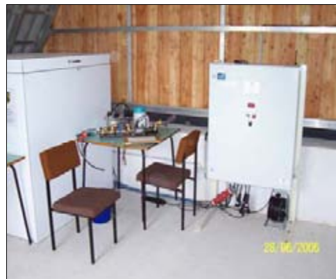
Abb. 10: Fertiger Ausbau der GrWM I mit Winterumhausung (links), Durchflussmesszelle für die Wasserprobenahme (Mitte) und Schaltschrank (rechts)
