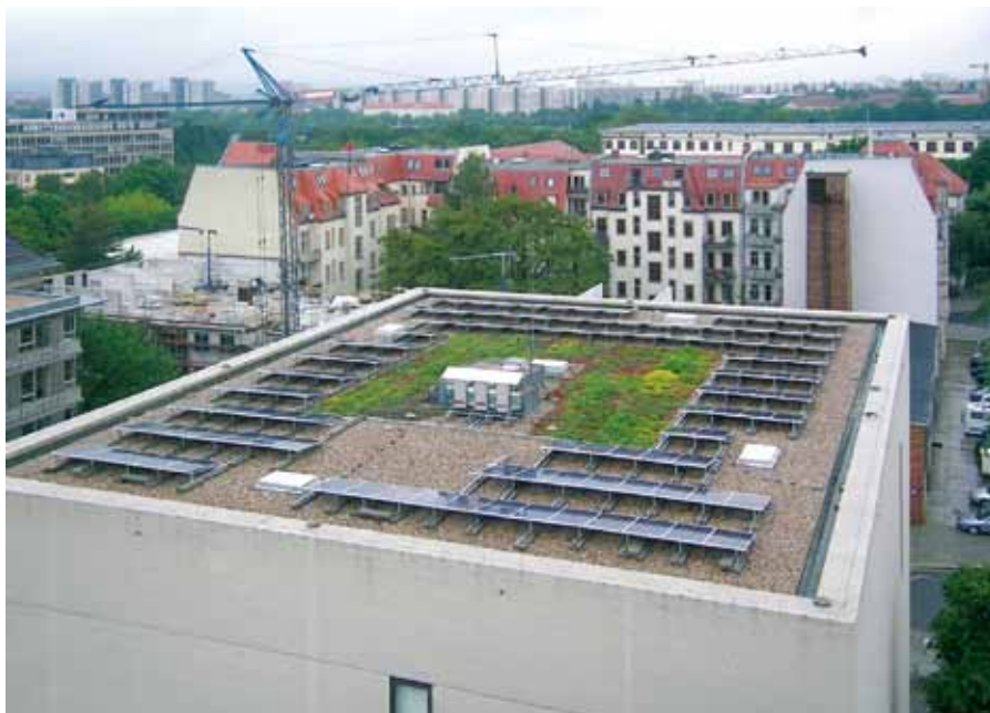
Photovoltaikanlage auf dem Dach des Magazinneubaus
