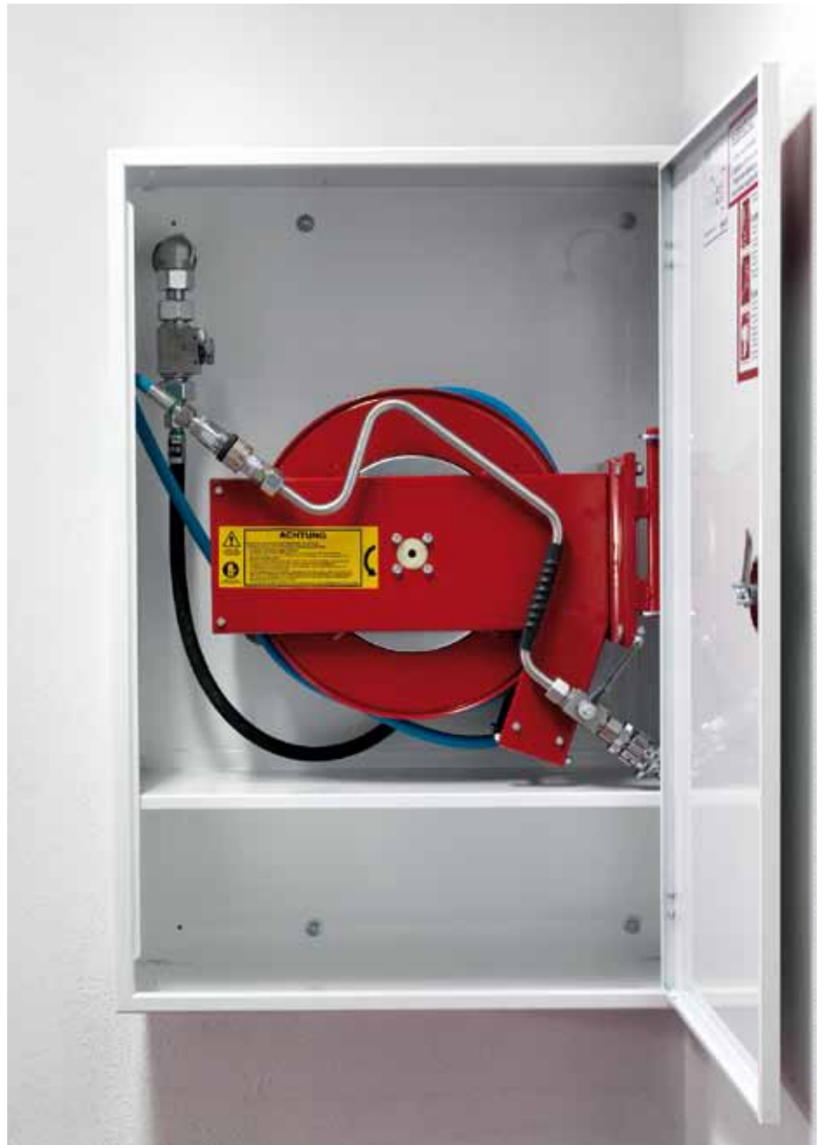
Wandhydrant mit Hochdruck-Wassernebellöscheinrichtung im Treppenhaus Magazinaltbau
