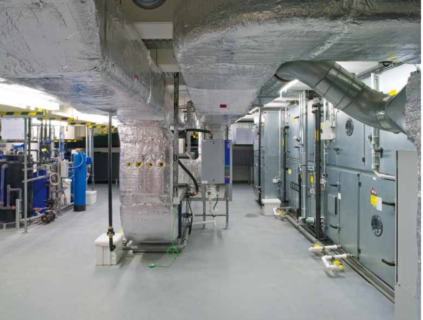
Technikzentrale im 1. Untergeschoss des Magazinneubaus
