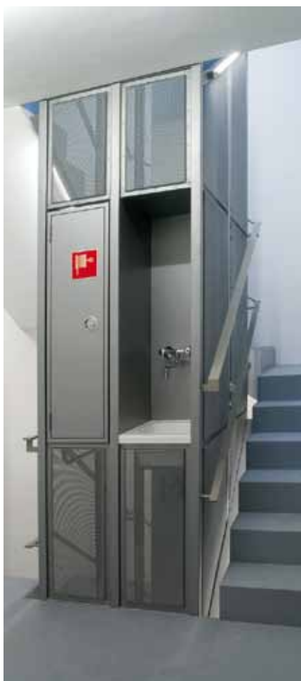
Treppenhaus mit Installationsschacht und Wasserentnahmestelle
