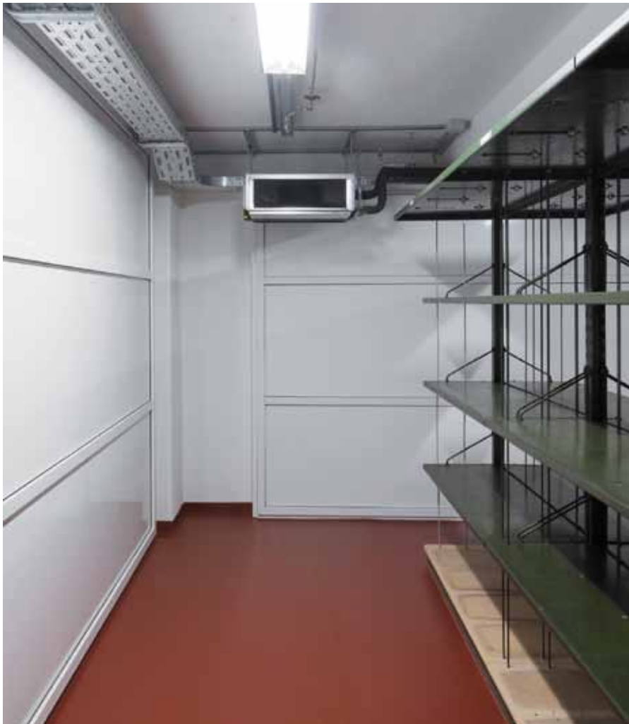
Archivraum (Ecksaal) nach Fertigstellung der Dämmebene, die Fenster sind vollständig verschlossen, Umluftkonvektor wurde an der Decke installiert.
