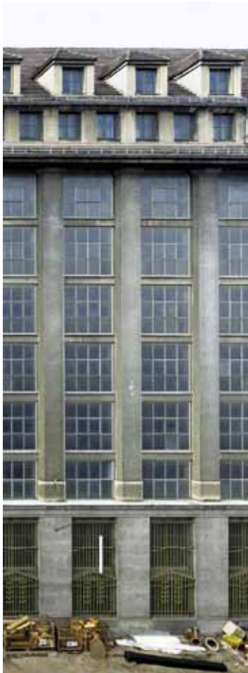
Stark verschmutzte Hoffassade des Magazinaltbaus vor der Sanierung
