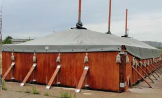
Hackschnitzeltrocknung mit Dombelüftungsverfahren
