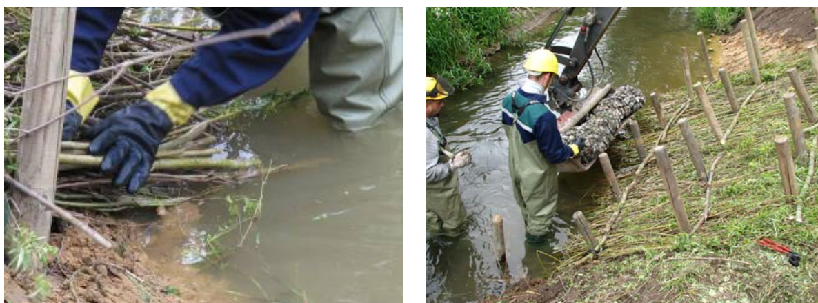
Abbildung 42: Ufersicherung mit Weidenspreitlagen an der Eula im Rahmen eines DWA-Nachbarschaftstages (links: Weidenlagen legen, Enden liegen zum Wurzeln im Wasser, rechts: die Fußsicherung erfolgt mittels Steinwalze)
