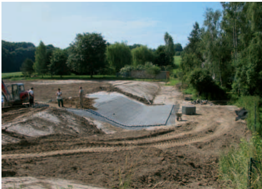
Bau eines befestigten Notüberlaufbereiches zum kontrollierten Wasserabfluss Foto: Teilnehmergeinschaft Zschadraß (Hochwasser-) Muldedörfer
