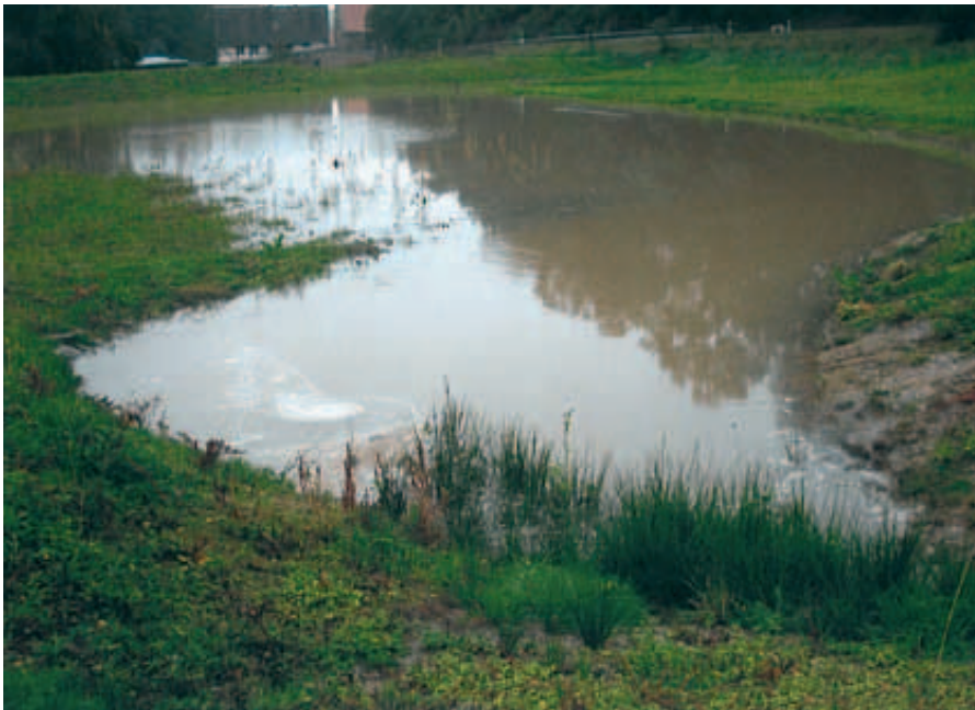
Erste Bewährungsprobe für einen Damm innerhalb der Anlage Foto: Teilnehmergeinschaft Zschadraß (Hochwasser-) Muldedörfer
