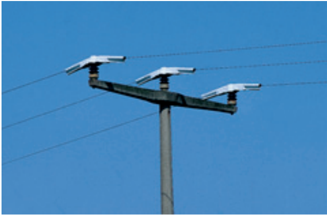
Abb. 82: Schutzhauben auf stehenden Isolatoren; 1998, Welxande/Lkr. Riesa-Großenhain Foto: P. Reuß
