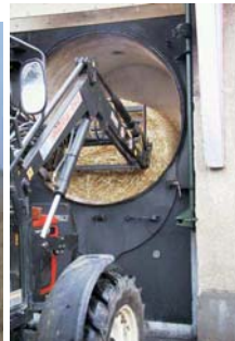
Abbildung 7 Beschickung des Strohballenvergasers in Wiesenburg
