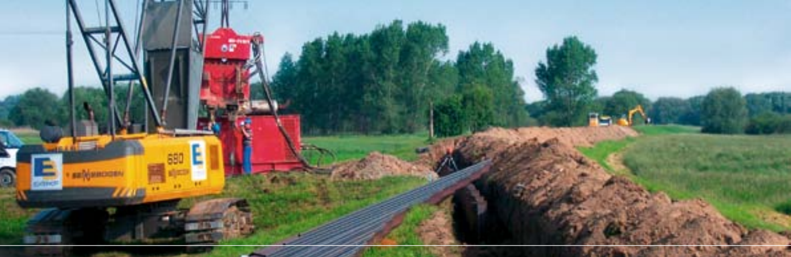
Deichsanierung an der Vereinigten Mulde bei Nepperwitz durch den Einbau einer Spundwand
