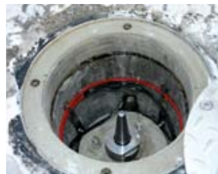
Neue Alignementskegel an der Talsperre Gottlauba
