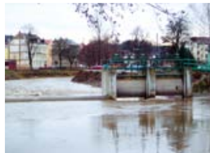
Verteilerwehr: Freiberger Mulde zum Flutgraben
