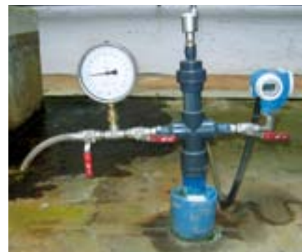
Sohlenwasserdruckmessstelle mit neuen Entlüftern am Speicher Borna
