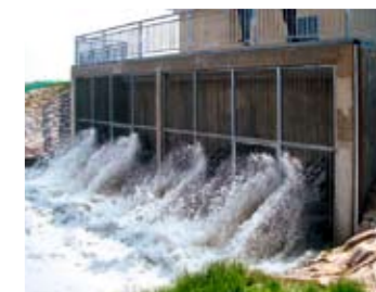
Schöpfwerk Jerisau, Pumpentest
