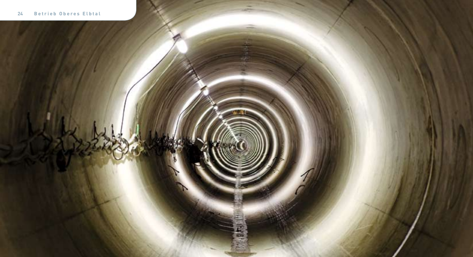
Hochwasserentlastungsstollen an der Talsperre Klingenberg
