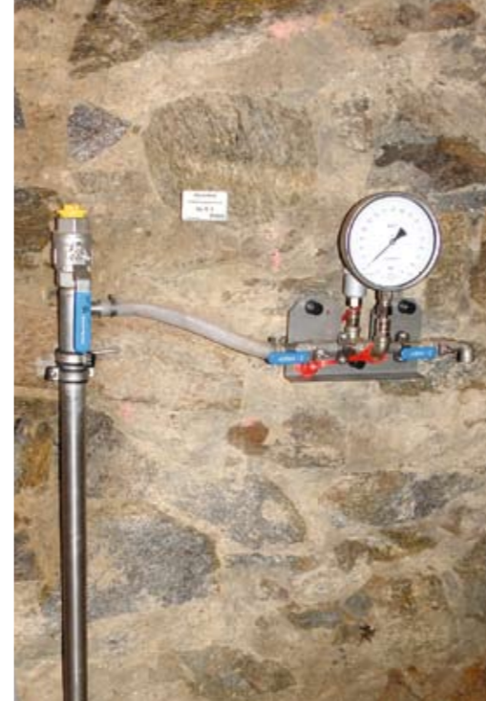
Sohlwasserdruckmessstelle im neuen Kontrollgang der Talsperre Klingenberg
