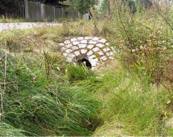
Versickerungsschacht am Heilmanns Weg in Niederfrohna
