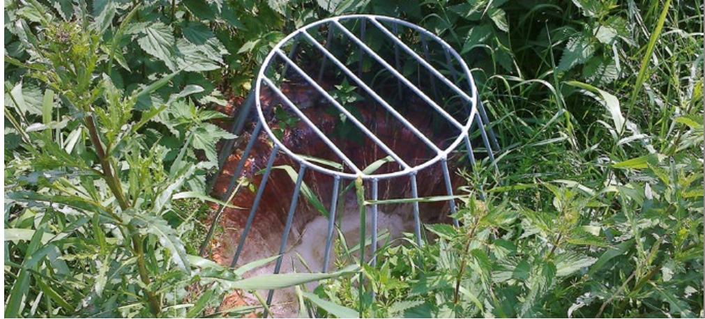
Versickerungsschacht an einem ländlichen Weg
