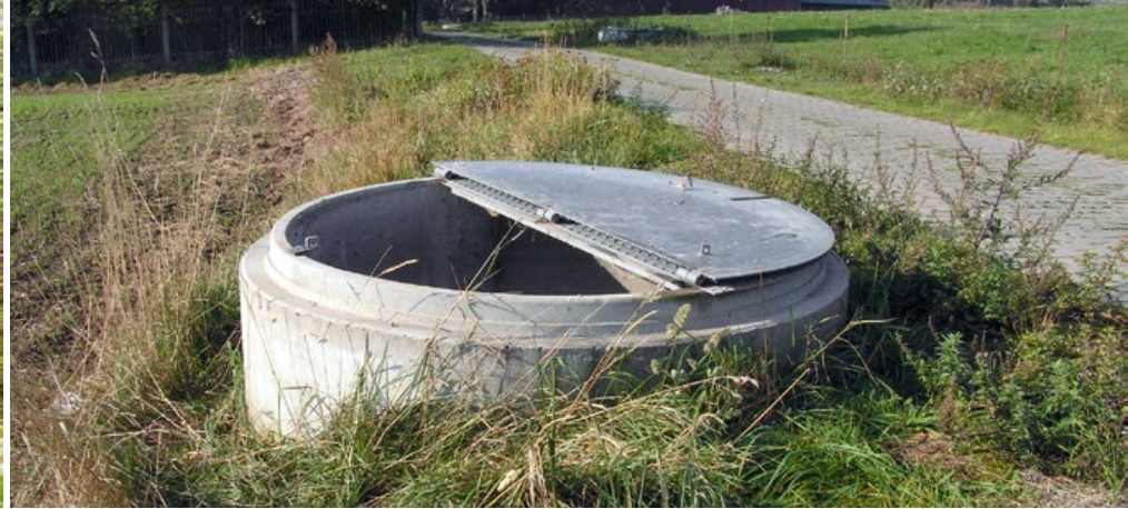
Versickerungsschacht am Heilmanns Weg in Niederfrohna
