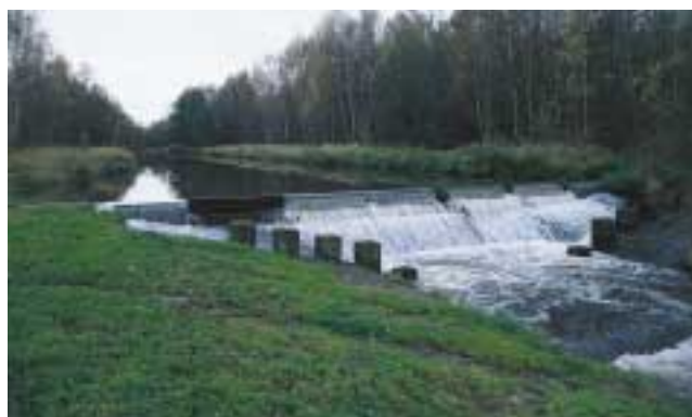
Abb. 146: Derartige Querbauwerke können von Wanderfischen nicht mehr passiert werden – ein Beispiel an der Pleiße bei Stöhma.
