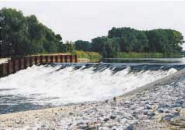
Abb. 158: Obwohl diese Wehrrampe geneigt ist, stellt sie aufgrund der zu starken Fließgeschwindigkeit für die meisten wandernden Fischarten ein unüberwindbares Hindernis dar.
