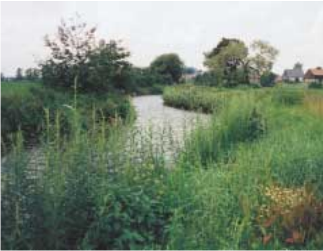
Abb. 165: Auch dieses Ufer bei Pfaffenhain ist durch Faschinen befestigt. Die eingebauten Faschinen wurden mit Mutterboden angefüllt und mit Grassamen besät, so dass sich ein bewachsener und stabiler Böschungsbe- reich entwickelt. Aufnahme: Juli 1997.
