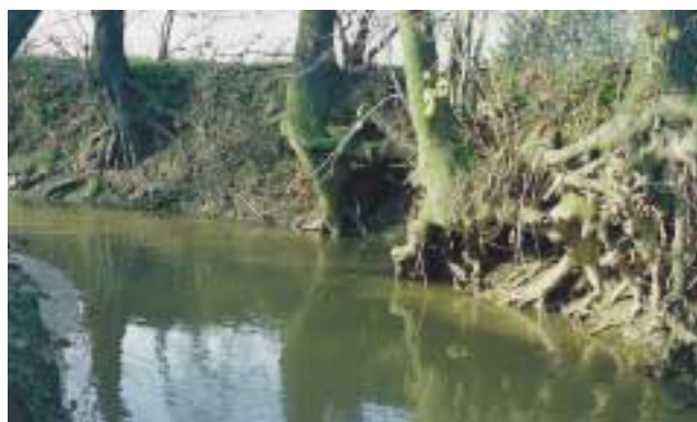
Abb. 149: Die Stellung der Ufergehölze zeigt die übermäßige Eintiefung des Gewässers an.
