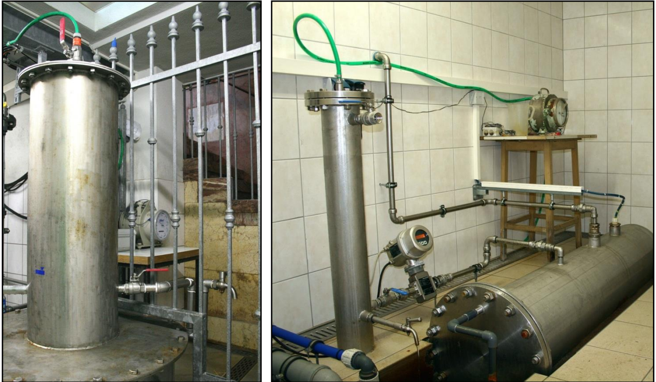
Abbildung 5: Gasflussmessstationen an den Quellfassungen von Eisen- (links) und Schillerquelle (rechts)
