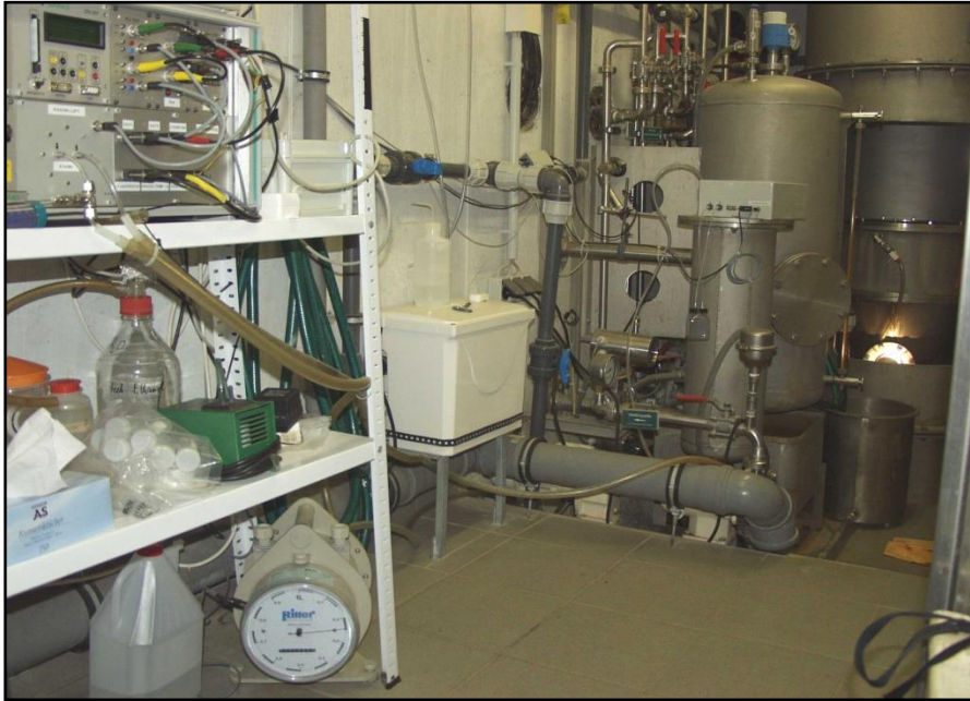
Abbildung 3: Keller der Wetтинquelle (Bad Brambach) mit Quelfassung und seismohydrologischer Multiparameterstation
