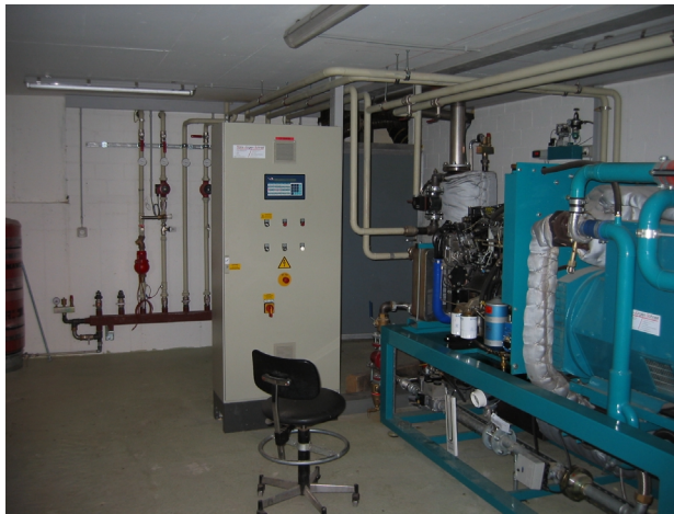
Bild 2 BHKW im Technikraum der Anlage Ott
