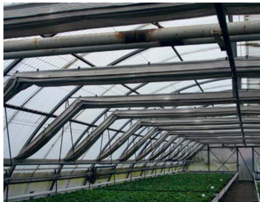
Abb. 46: Energieschirme leisten auch in Altanlagen einen wertvollen Beitrag zur Reduzierung des Energieverbrauchs (Quelle: SEF)
