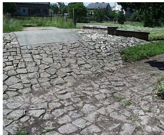
Abbildung 2-32: Hindernis bei Zufahrt zu Fläche 1 (gemauerte Bogenbrücke, nicht PKW-tauglich) (06/2001)
