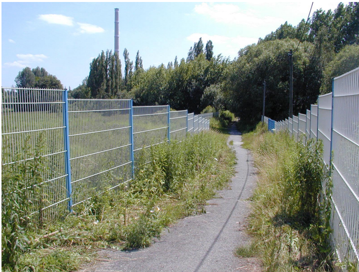
Abbildung 5-3: Punkt 37 – Beispiel für nicht vorhandenen Zugang zum Untersuchungspunkt
