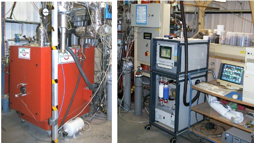
Abb. 28: Kesselprüfstand des Instituts für Luft- und Kältetechnik gGmbH Dresden (ILK)
