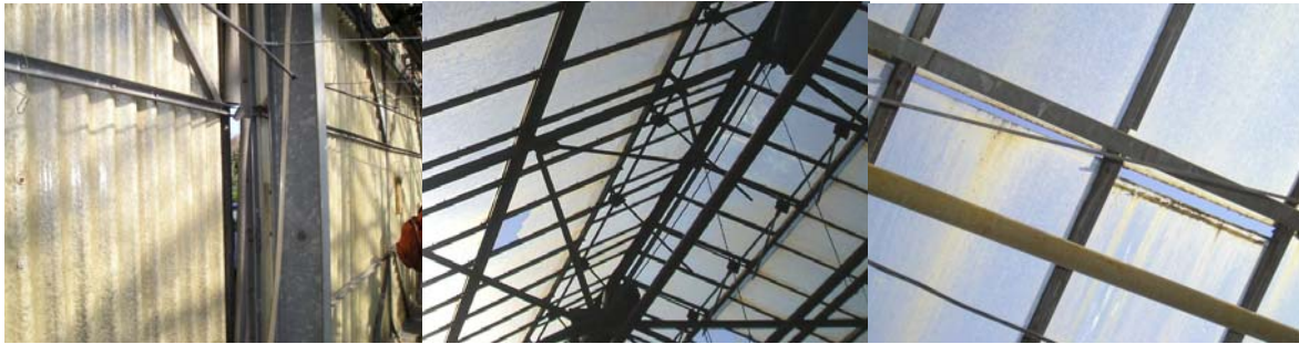
Abbildung 43: Beispiele der Wärmeabfuhr über den Luftwechsel (von links nach rechts: schlecht schließendes Tor, gebrochene/abgerutschte Scheiben) 93
