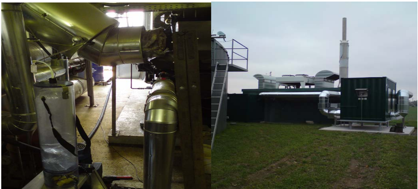
Abbildung 14: Beispiele für einen Katalysator und eine TNV an BHKW
