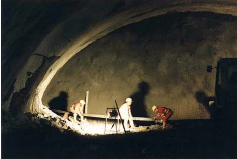
Abbildung 19: Beleuchtungsbock mit einem Scheinwerfer vor der Ortsbrust
