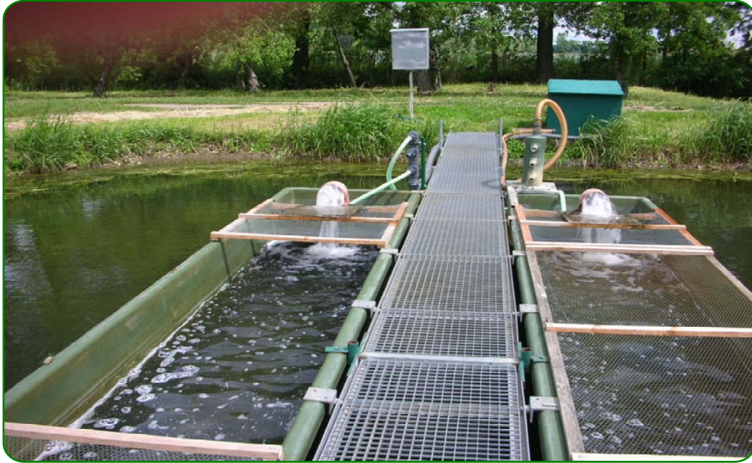
Abbildung 1-2: Rinnenanlage in VT7. Ausbaustufe 2006. Im Hintergrund links Schalt-schrank mit Datenlogger für Sauerstoffmessdaten, rechts Gebläse für HP-Förderer
