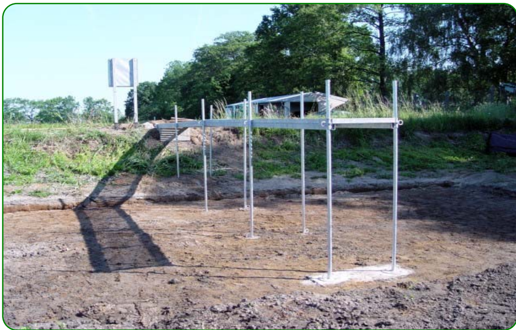
Abbildung 1-7: Ein mittig angeordneter Steg gewährleistet die Begehbarkeit der Anlage.
