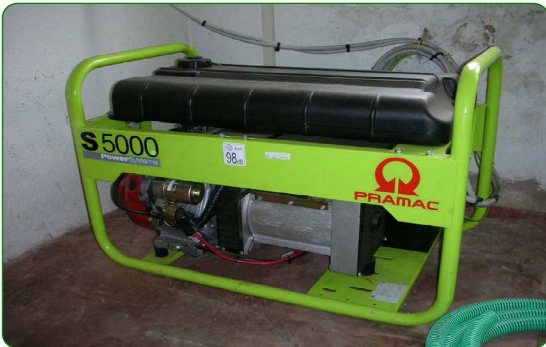
Abbildung 1-3: Selbst startendes Notstromaggregat zur Energieversorgung aller ITK-Anlagen bei Netzstromausfall
