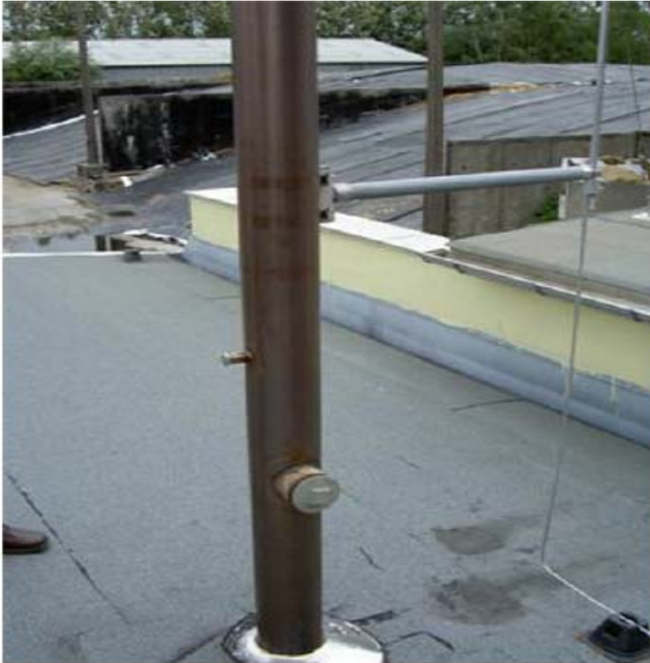
Abbildung 3: Messstelle am BHKW 1/1
