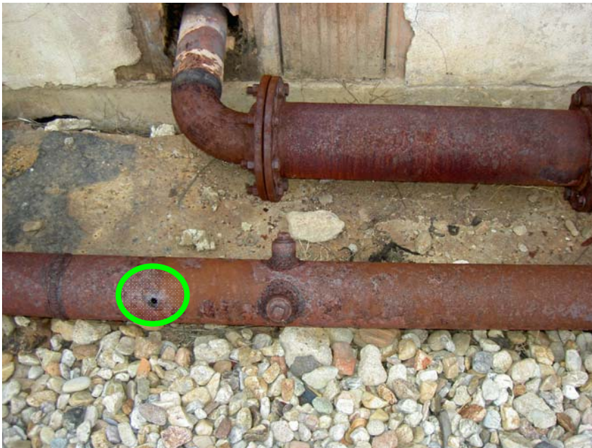
Abbildung 7: Messstelle am BHKW 9/3
