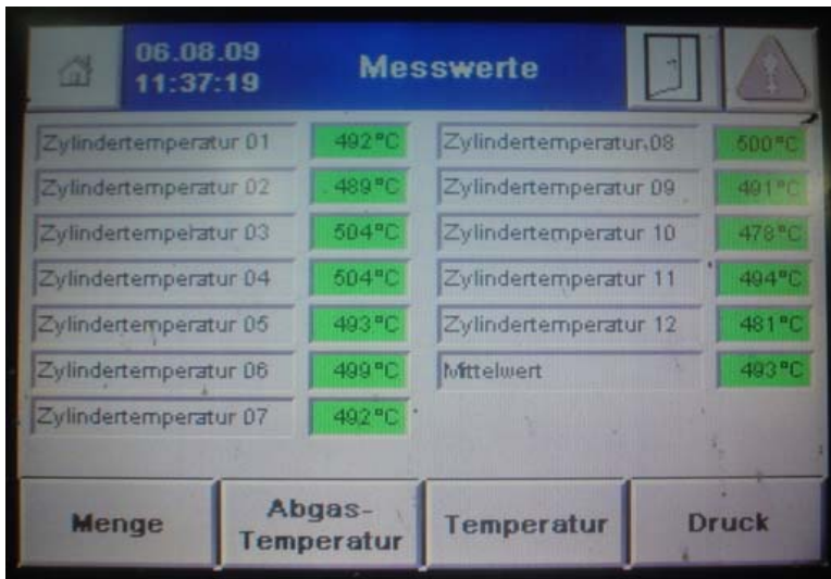
Abbildung 23: Schaltschrankdisplay zum Ablesen der Zylindertemperaturen
