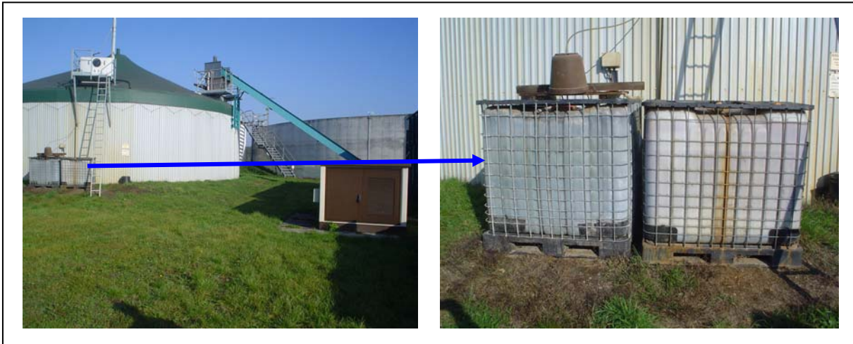
Abbildung 28: Entschwefelung mittels Eisensalzen → Vorratsbehälter der Salzlösung (rechts)
