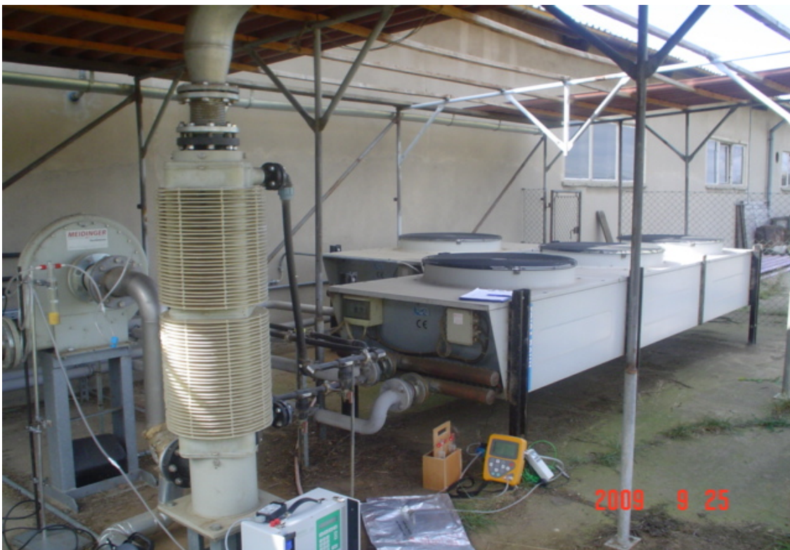
Abbildung 31: Technische Gaskühlung (z. B. BHKW „60“)
