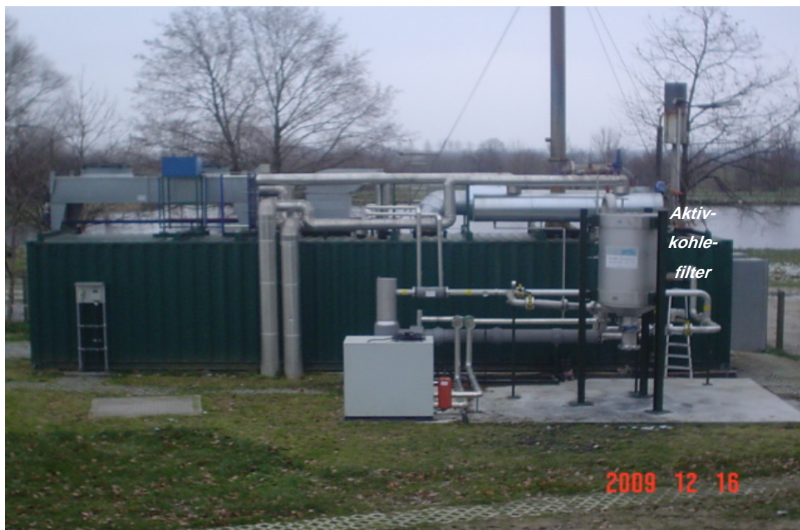
Abbildung 29: Zusätzliche Entschwefelung mittels Aktivkohlefilter vor dem Gaseintritt in das BHKW „54“
